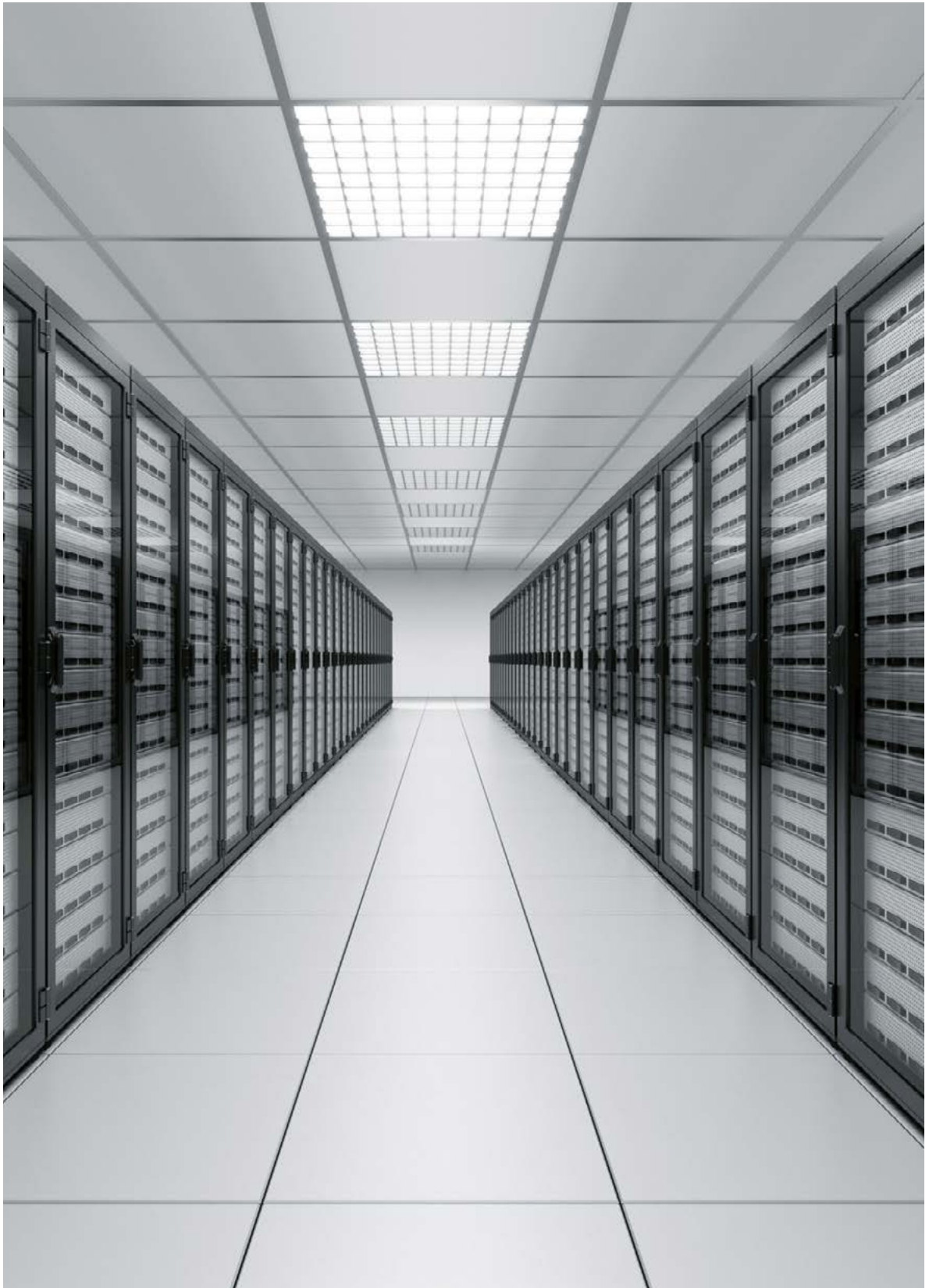
Salle de serveurs
